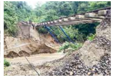
津軽線被害状況 (令和4年8月)
