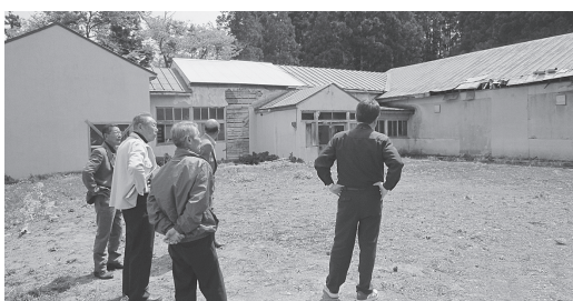
(旧今別保育園屋根破損現場)
