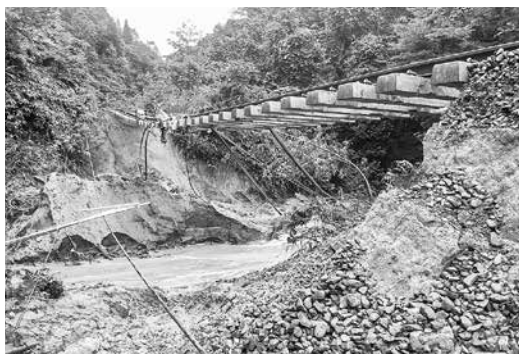
令和4年8月撮影 津軽線（被災状況）
