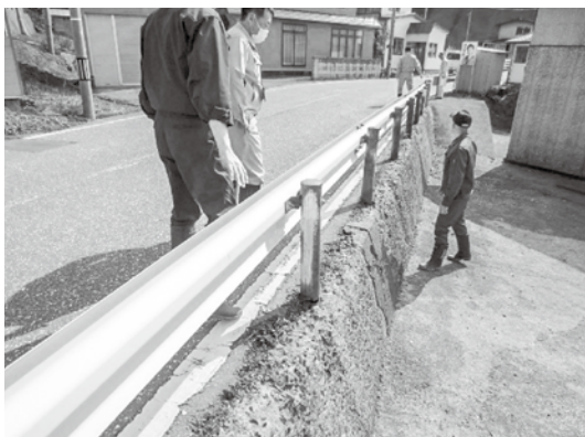
▲砂ヶ森地区の要望箇所視察の様子。支柱が腐食しており、大変危険な状態です。
