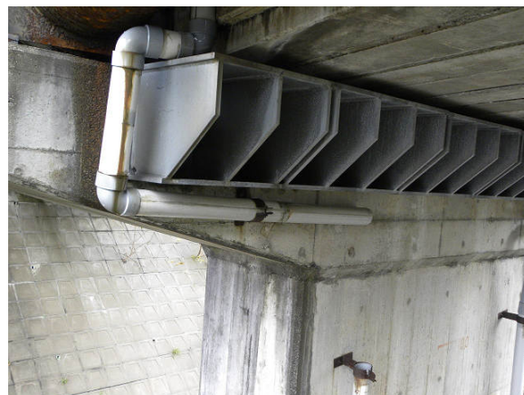
写真-2 中沢橋 排水管
