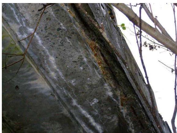
写真-11 今別母沢 11 号橋 主桁下面
