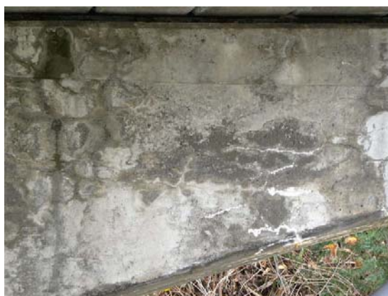
写真 3-1 塩害と思われる損傷 (長川水源池橋・橋脚梁部)
