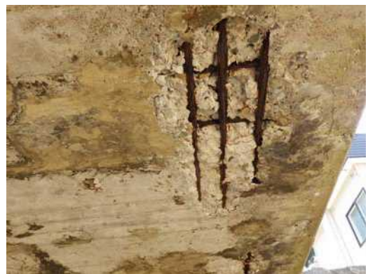
写真 3-1 塩害による損傷状況例 (床版：鉄筋露出)
