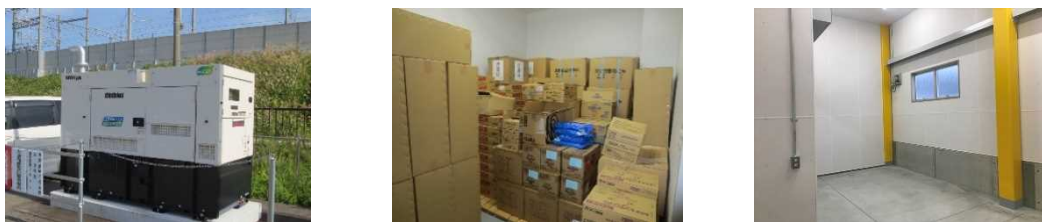
左側：駅非常用電源装置（令和3年度設置） 停電時、現道の駅の電気をカバーする。 中央：「いまべつ総合体育館」内に災害支援物資を備蓄している。（町・JR北海道共同） 右側：除雪ステーション（災害支援物資備蓄倉庫内）（令和3年度設置）
